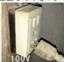
コンセントの抜き 不完全な差し込み
